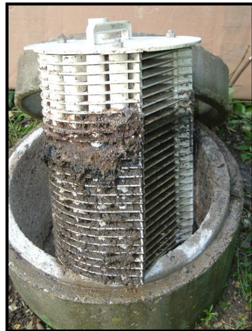
A dirty EFFLUENT screen.
